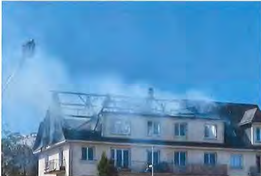
Les flammes ont ravagé une bonne partie de la toiture de l'immeuble. ©DR
